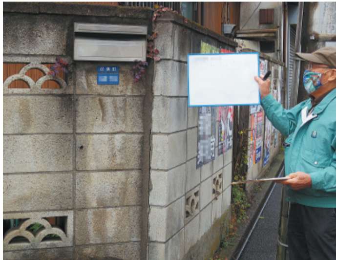
倒壊の恐れがある危険なブロック塀を発見
