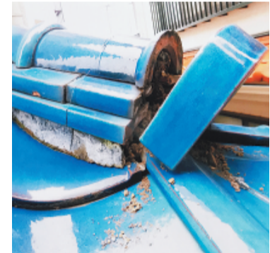
破壊された鬼瓦と屋根
