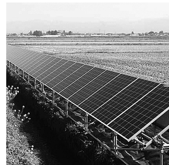
中央土地改良区第4 太陽光発電所（会津坂下町）
