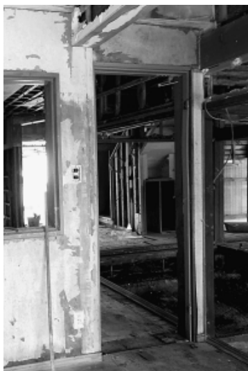
岡山豪雨の被災現場
