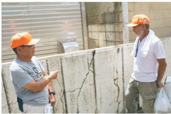
危険な塀を点検 (西東京市内)
