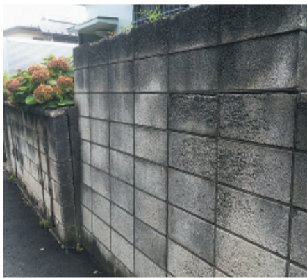
池袋地域で見られた危険なブロック塀
